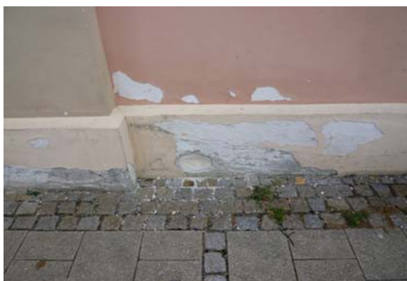
Bild 1: Der Sockel vor der Sanierung
