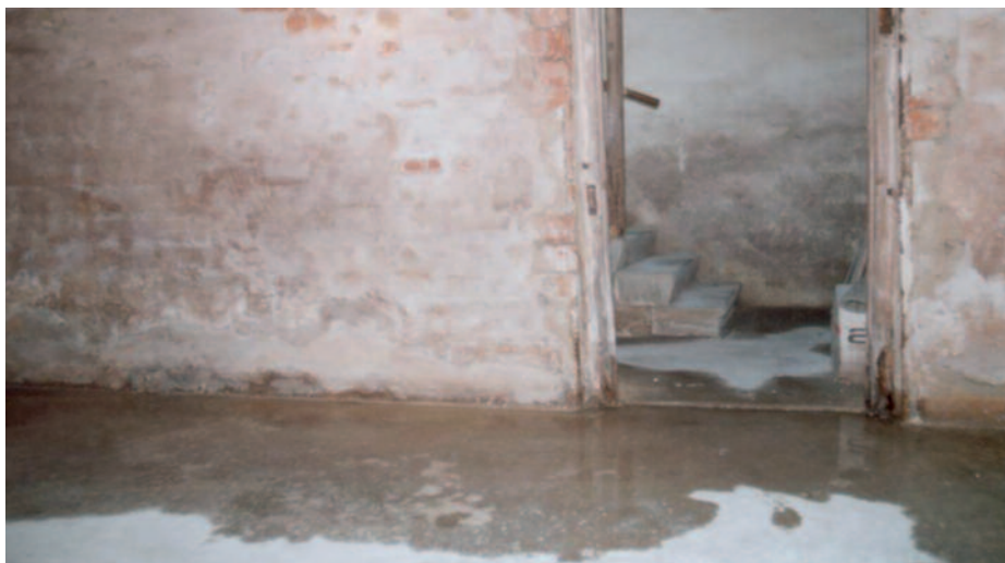
1 Druckwasser ist in einen Keller eingedrungen. Eine fachgerecht ausgeführte Innenabdichtung hätte das verhindert.
