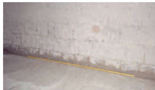
4 Nach Abschlagen des Putzes und Entfernen des Bodenbelags zeigt sich, dass die vorhandene Horizontalabdichtung noch funktioniert. Nach der Abdichtung des Bodens und dem Neuverputz der Wände mit einem Sanierputzsystem sind die Kellerräume wieder nutzbar.
