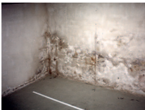
5 Kapillarwasser hat die Kellerwände durchfeuchtet.
