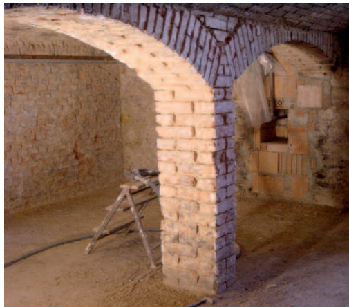
6 Bei diesem Gewölbekeller sind die Wände aus Naturstein und Ziegel durchfeuchtet.
