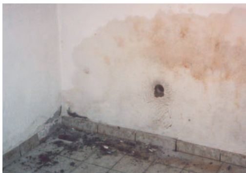
2 Hier ist Wasser durch den Boden in den Keller gedrungen und hat auch die Wände durchfeuchtet.
