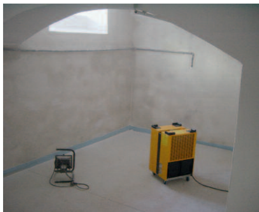
7 Kondenstrockner sorgen dafür, dass der Sanierputz möglichst rasch seine Eigenschaften entwickeln kann und beständig gegen die rückseitige Feuchtigkeits- und Salzbelastung ist.
