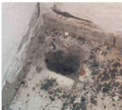
3 Eine Probebohrung zeigt, dass die Bodenplatte wassergesättigt ist.
